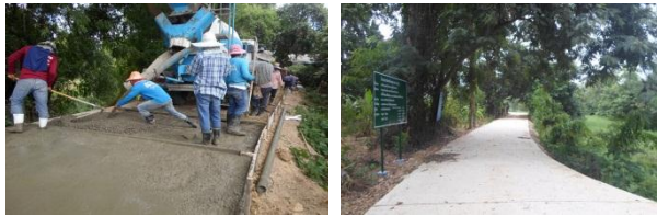
ก่อสร้างถนน คสล.(เลียบบแม่น้ำเพชร) หมู่ ๖ บ้านท่ามะเกลือ
